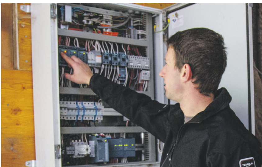
Im Sicherungskasten im Stall ist auch das hydraulische Rührwerk vertreten, wie Patrick Rudin erklärt.
